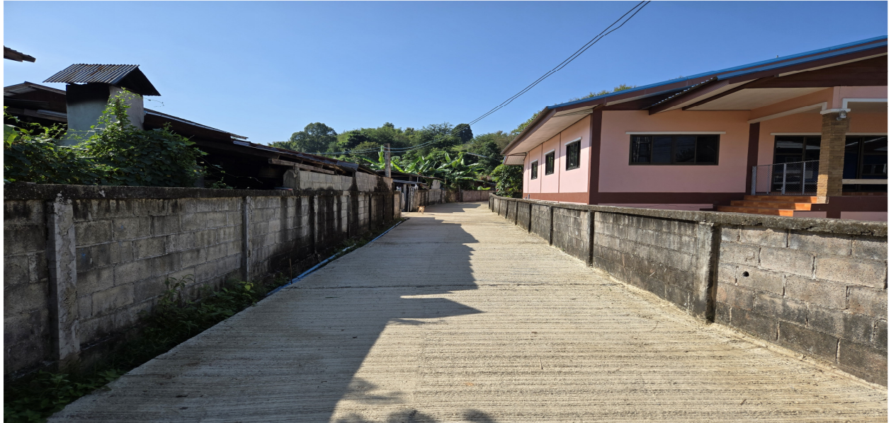
๒๓.โครงการก่อสร้างถนนคอนกรีตเสริมเหล็ก บ้านดงคำ หมู่ ๑๓ (ซอยนายอ้วน ตามัย -นางลี ตามัย) ขนาดกว้าง ๒.๕๐ เมตร ยาว ๕๕ เมตร หนา๐.๑๕ เมตร
